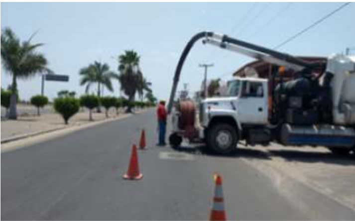
Mantenimiento preventivo al cárcamo
