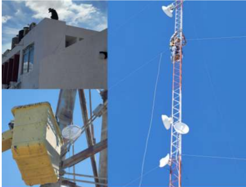
Instalaciones de red de Fibra Óptica de alta velocidad
